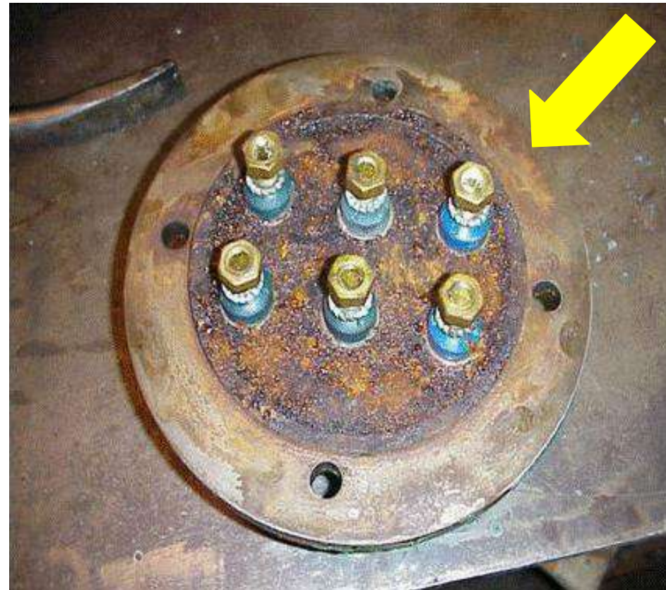
Corrosion avancée de la portée ADF
