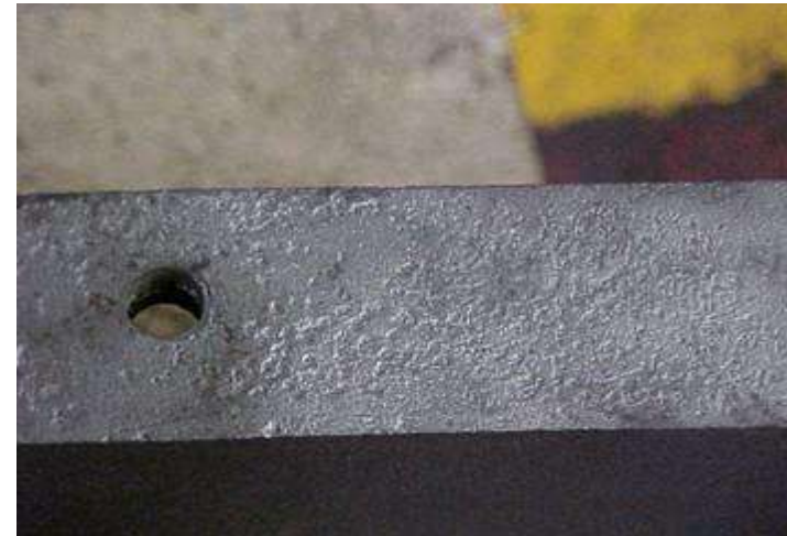
Surface rouillée après nettoyage
