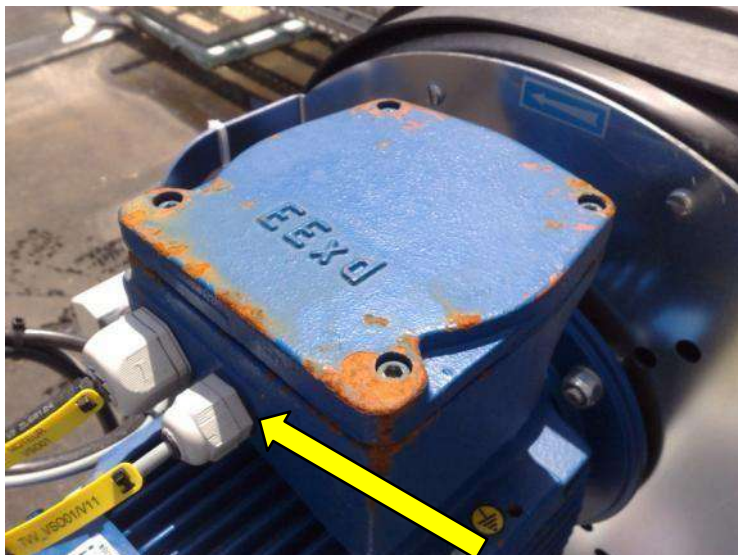
Entrées de câble non Ex d « INTERDIT »
