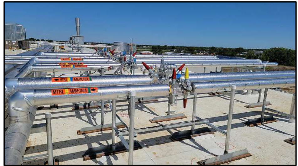
Les condensateurs / le toit
